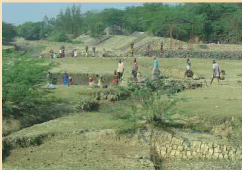
Bouw van dijken in de Ganges delta (India, Bangla Desh). Hier valt nog wel wat winst door aanpassing te behalen.
